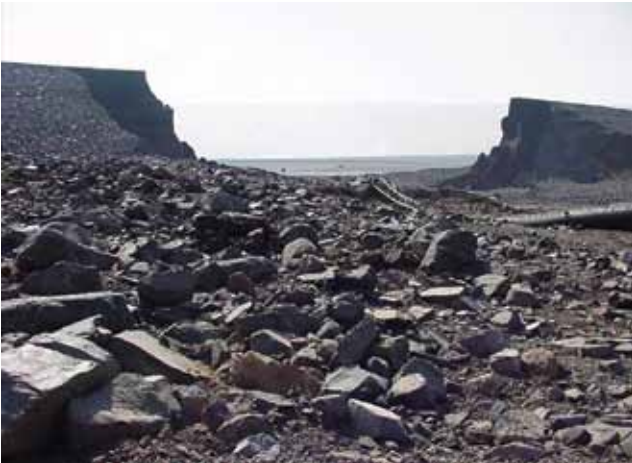
شكل 3.6. الجزء المنهار من جسم سد زيزون الواقع في شمال غرب سورية بتاريخ 4/6/2002، ولقد تسبب هذا الانهيار في اندفاع مياه بحيرة السد بشكل سريع وعنيف نحو قرية زيزون موديا بحياة 21 شخصاً ودمار 251 منزلاً، وسبب أضراراً كبيرة في عدة قرى مجاورة، مخلفاً مئات المشردين. [المصدر: الاتحاد الدولي لجمعيات الصليب الأحمر والهلال الأحمر، 2003 و نجم، 2008].
