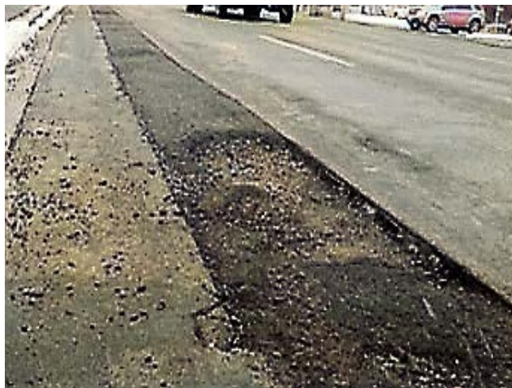
شكل (٤-٢): تآكل وتطاير سطح الطريق في موقع الحفرية
