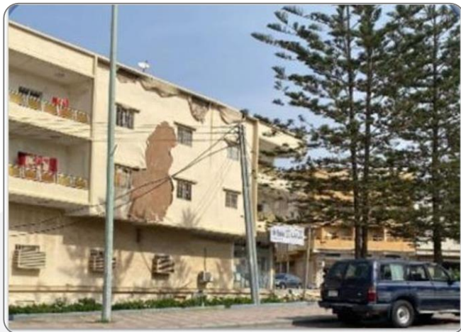
شكل (12): تشققات على واجهة المباني
